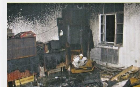
Uklízení takto může vypadat byt po požáru od zapnutého elektrického spotřebiče ponechaného bez dozoru.
